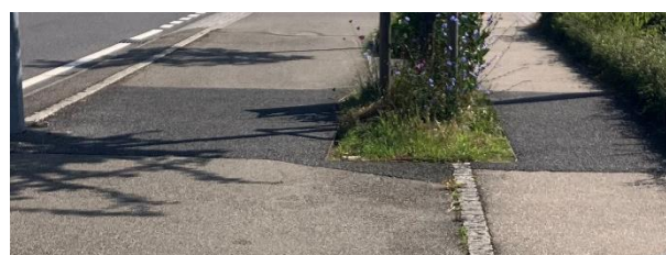
Bitume poreux à proximité de fosses d'arbre sur voies piétonne
