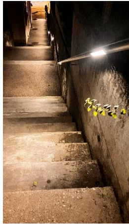
Luminaire intégré à la main courante (Neuchâtel)
